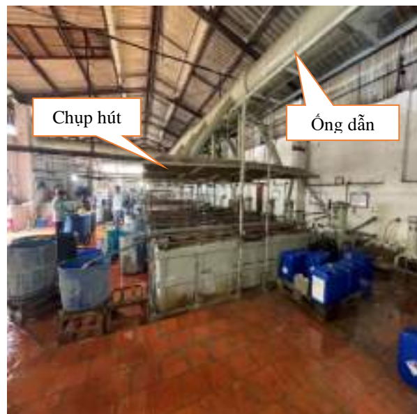
Hệ thống chụp hút, ống dẫn tại xưởng cũ
