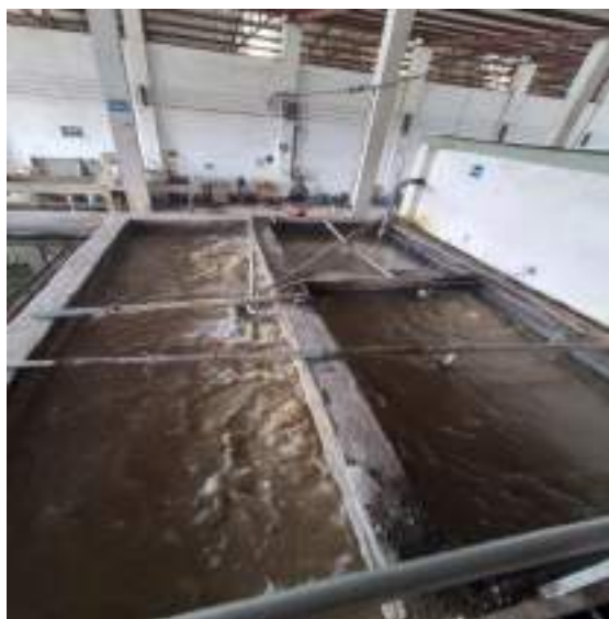
Bể trung hòa
