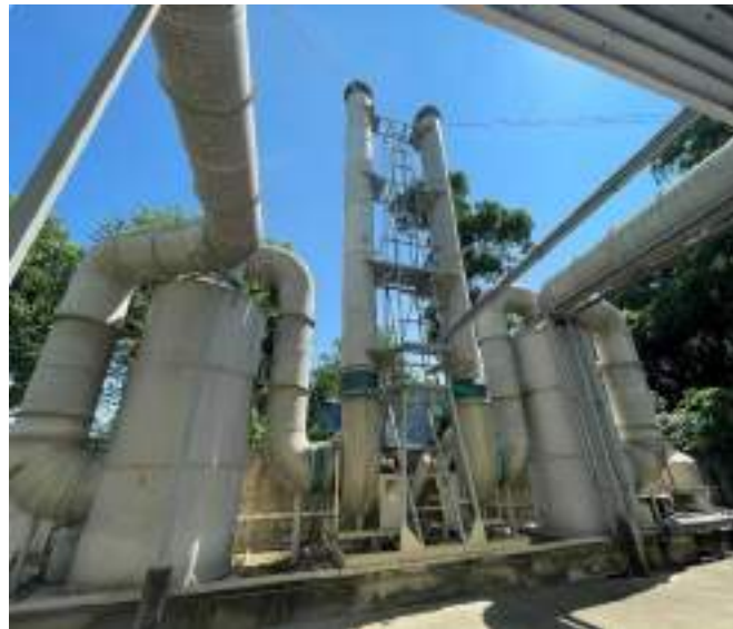
Hình 3. 16. Tháp xử lý khí thải của dây chuyền mạ kẽm tại xưởng 3A
