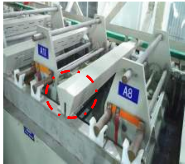
Hệ thống hút khí mặt bể
